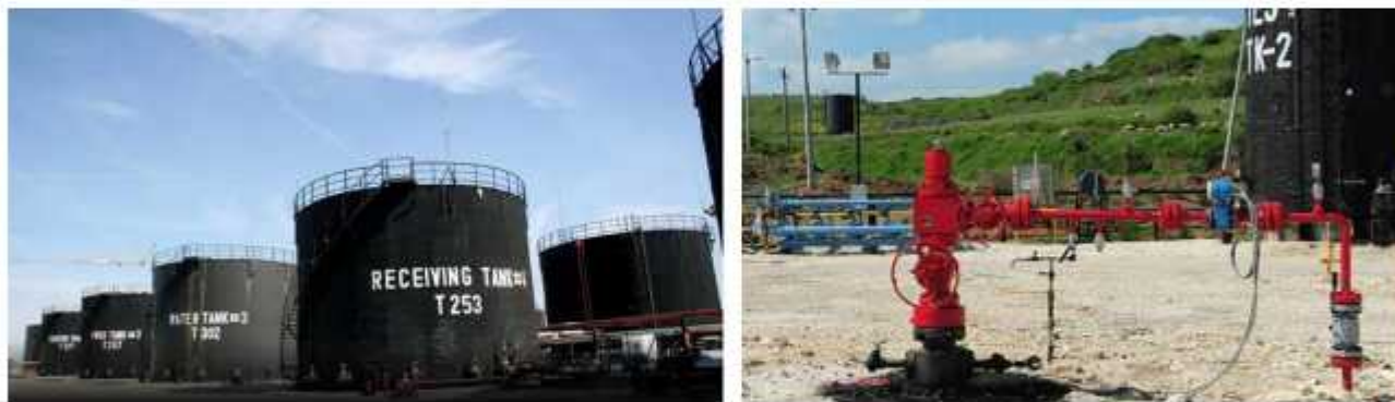
Figura 3 - Instalimet e impianteve të naftës brut në vendburimin Patos Marinzë (kompania Bankers Petroleum Albania Ltd.)
